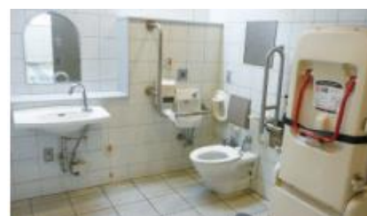
写真6 3) 多機能トイレ 車椅子の回転用スペースが 確保され、ユニバーサルベ ッドが設置されている。
